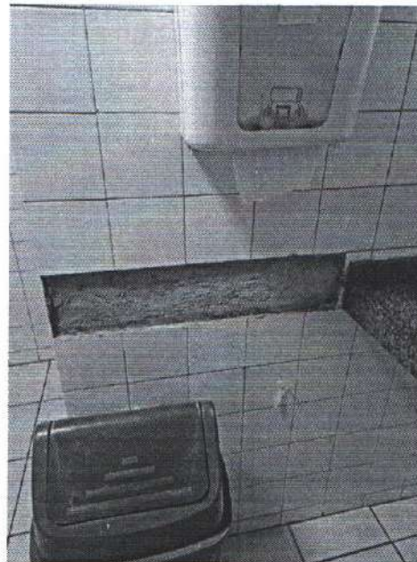
Figura 9 – Forro e iluminação necessitando de manutenção. Fonte: acervo pessoal. Figura 10 – Banheiros terreo. Fonte: acervo pessoal.
